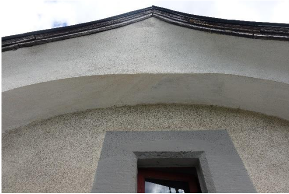
7_2023_7166_1 Vorzustand Anbau Dachuntersicht Oberflächenverschmutzung und Verfärbungen
