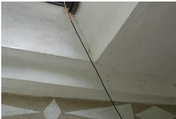
5_2023_7166_1 Vorzustand Fassade West mit Anbau Risse und loser Putz Dachuntersicht
