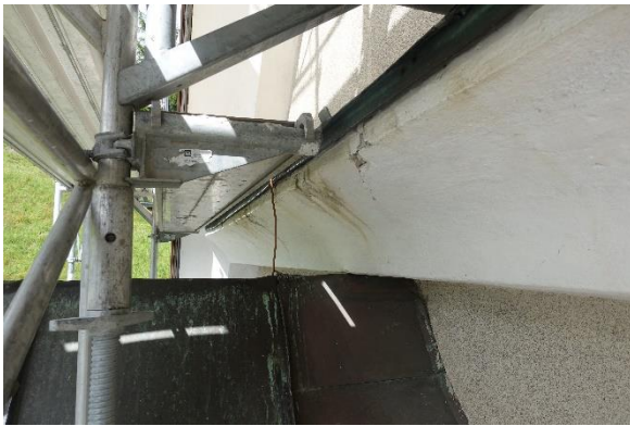
13_2023_7166_1 Vorzustand Fassade West, Dachuntersicht Oberflächenverschmutzung Verfärbungen Fehlstellen und Risse
