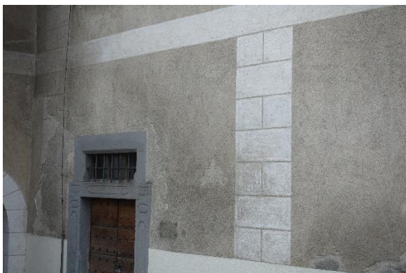
15_2023_7166_1 Vorzustand Fassade West Abplatzungen des Putzes durch Feuchtigkeit und Salze
