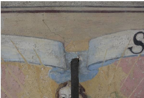
44_2023_7166_1 Wandmalerei Vorzustand Riss und Putzausbrüche
