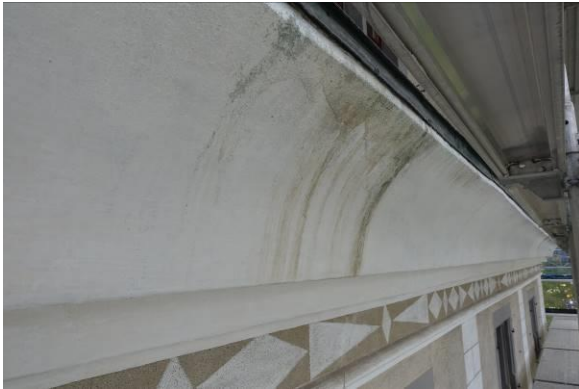
28_2023_7166_1 Vorzustand Ostfassade Verfärbungen vom Kupfer
