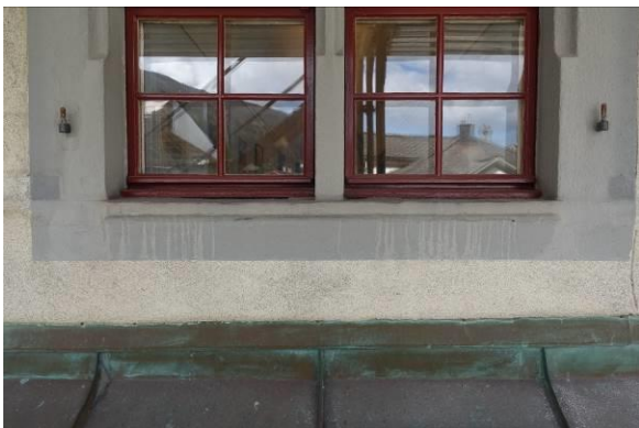
27_2023_7166_1 Vorzustand Ostfassade Rinnsuren und teilweise verblichene Farbe an der Fenstereinfassung.
