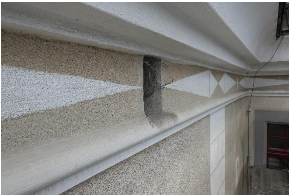
8_2023_7166_1 Vorzustand Anbau Oberflächenverschmutzung
