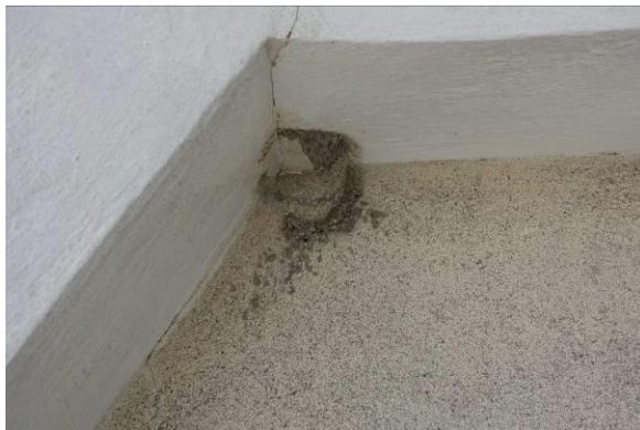
26_2023_7166_1 Vorzustand Ostfassade Rückstände von stark beschädigtem Nest
