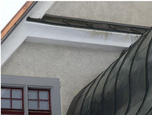
4_2023_7166_1 Vorzustand Fassade West mit Anbau Verfärbungen Dachuntersicht und Risse
