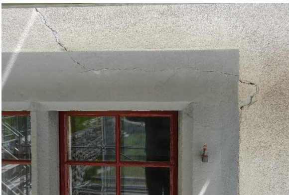
14_2023_7166_1 Vorzustand Fassade West Fehlstellen und Risse
