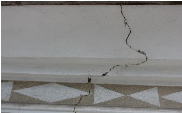
Abb.3 Vorzustand, Riss in Untersicht
